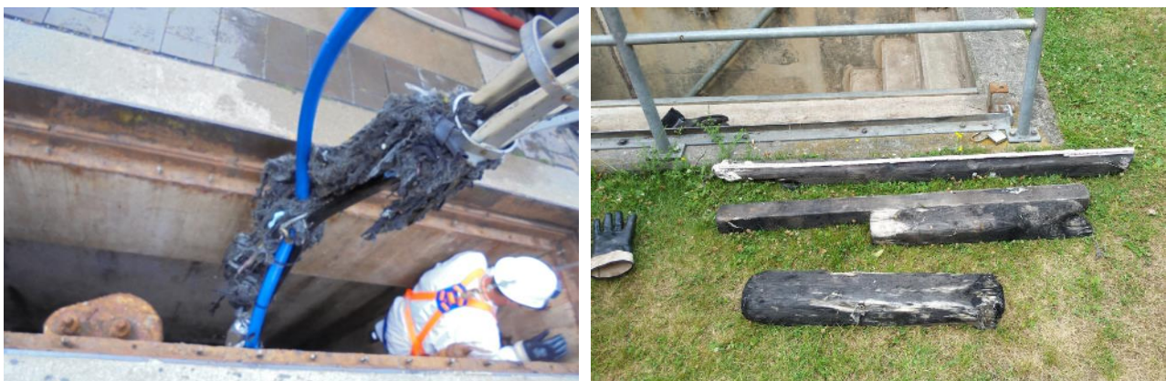
Feuchttücher, Vliesstoffe und Holzteile aus Düker
